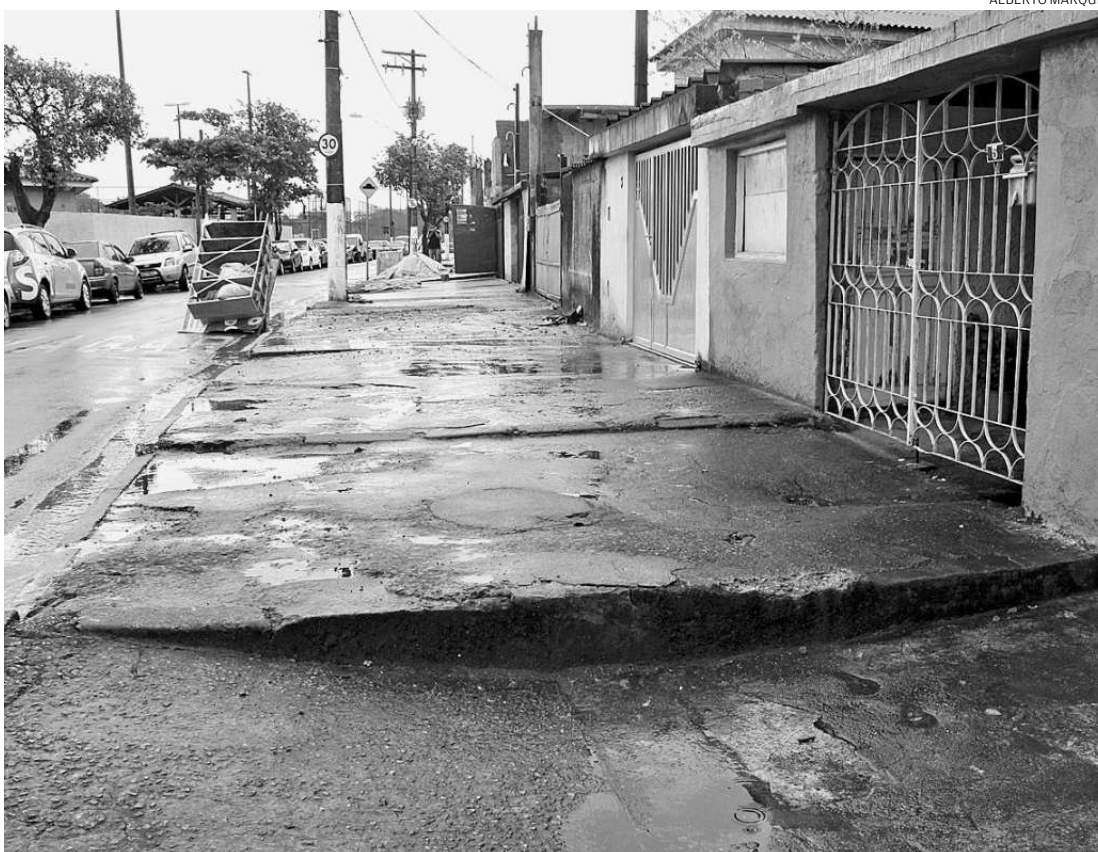
Hoje em dia, população convive com desníveis (como o da foto) e buracos: acessibilidade passa longe
