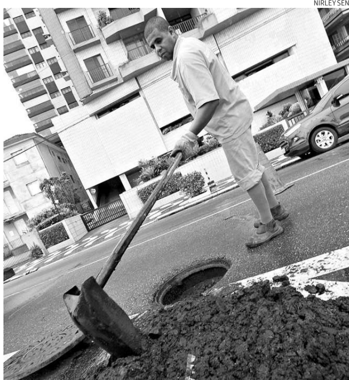
Cimento endurece e jateamento de água é insuficiente para limpeza
