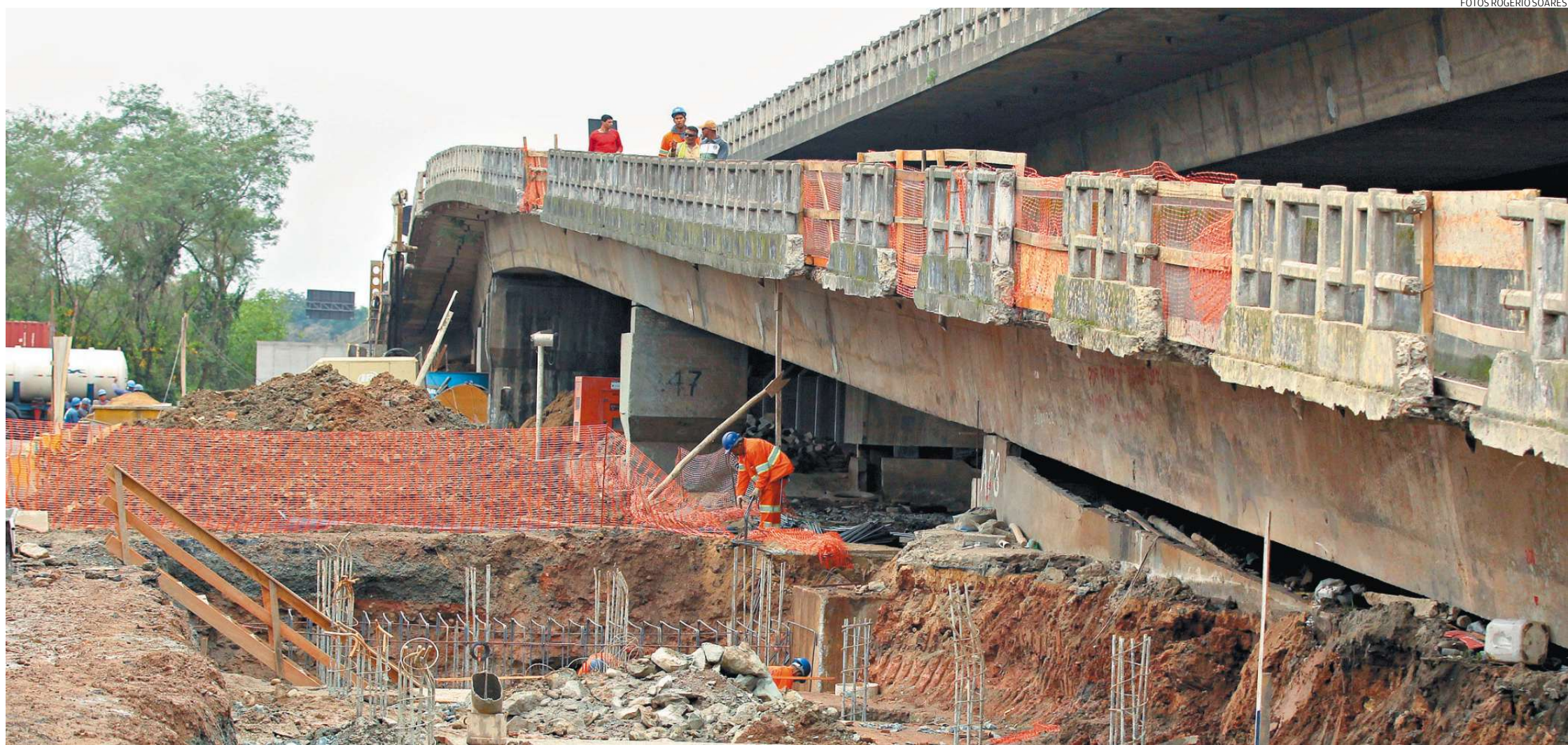
Uma das frentes de trabalho implantadas está iniciando a fase de duplicação da pista e da construção das novas alças de acesso ao viaduto sobre o Rio Cubatão e a Avenida Nove de Abril, na Vila Elizabeth
