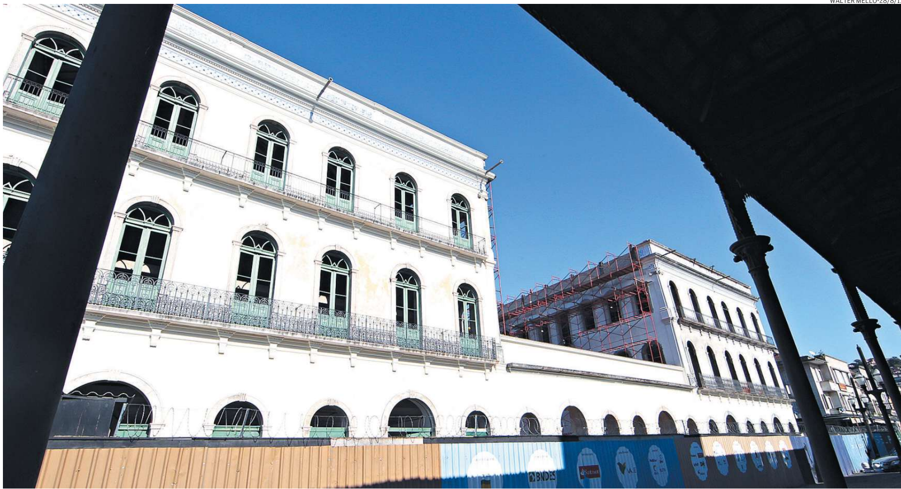
O Museu Pelé, cujo término das obras está previsto para maio de 2014, será a grande vedete de um roteiro turístico que visitará os lugares da vida do Rei do Futebol em Santos
