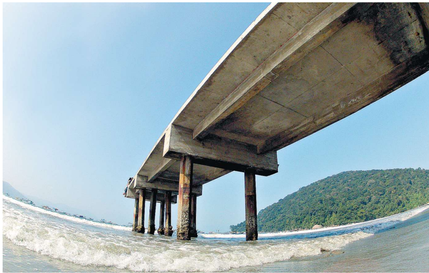
Pilares da estrutura estão deteriorados. Alguns, tortos. Não há sinal de quando as obras recomeçarão, apesar de promessa durante campanha
