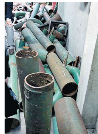
Tubulação do ar: toda corroída
