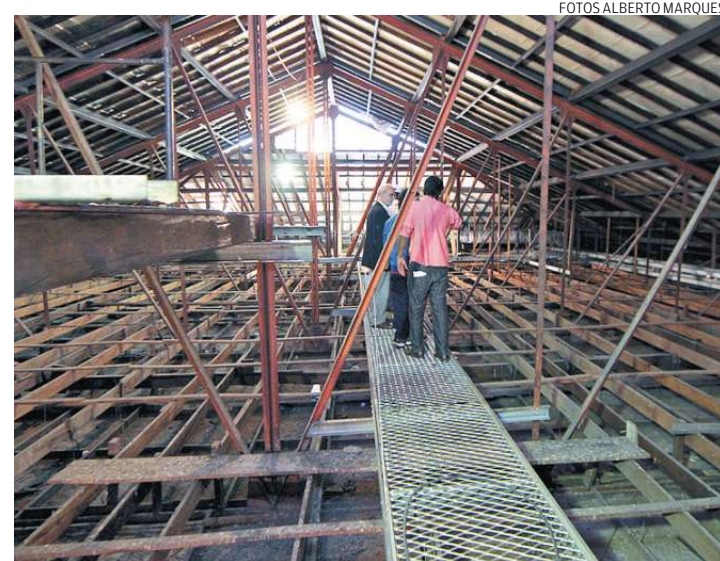
Telhado sobre o palco merece mais atenção, por causar infiltrações
