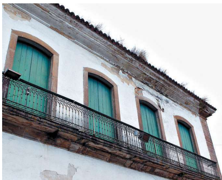
De fora, é possível ver a umidade que atinge o imóvel de 145 anos
