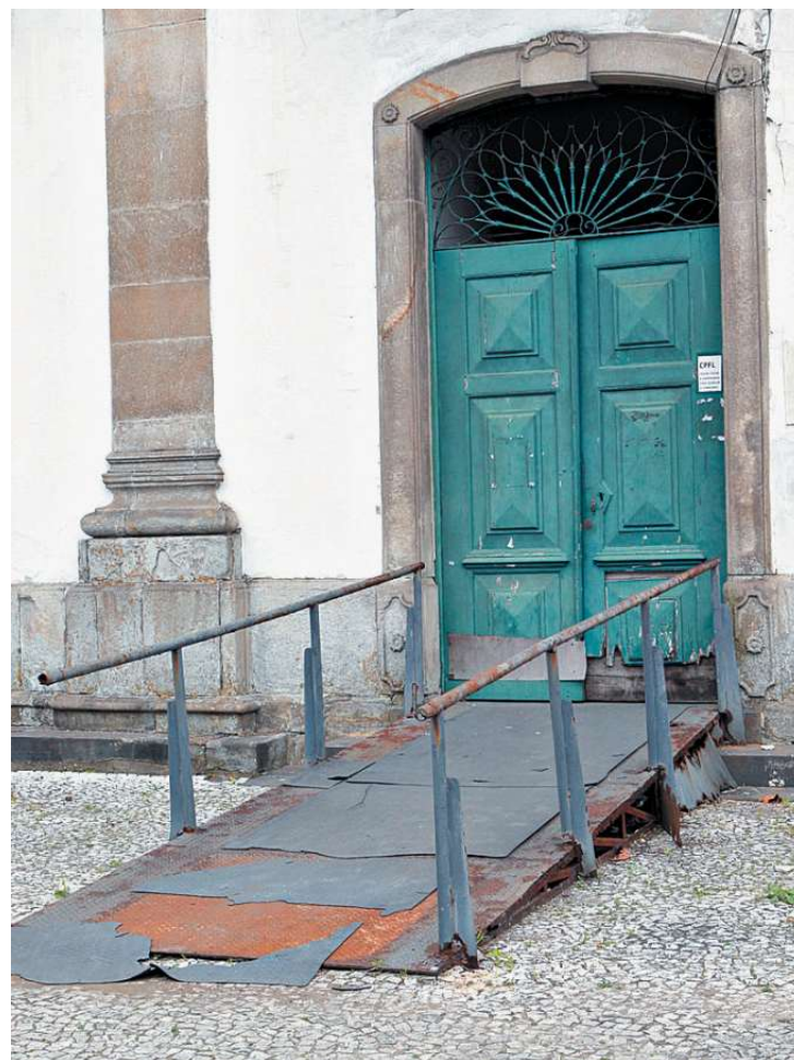
Rampa de acesso, portas e paredes também necessitam de reparos
