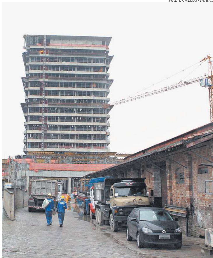
Apenas um terço do antigo galpão de café está de pé no Valongo
