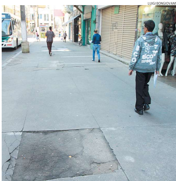
No Centro, má conservação e obras deixam seus vestígios no piso
