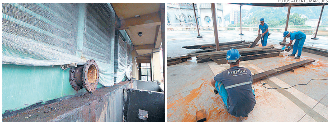
A Franz trocará o sistema de ar-condicionado. Funcionários da Inaplan já trabalham no reparo do telhado
