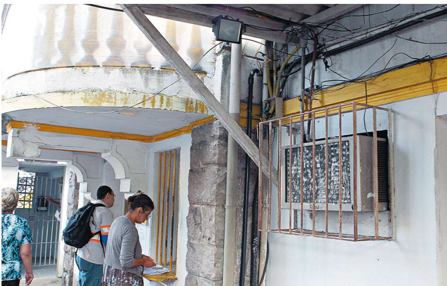
Próximo aos guichês de atendimento, um emaranhado de fios expostos oferece riscos às pessoas. Unidade também apresenta infiltrações
