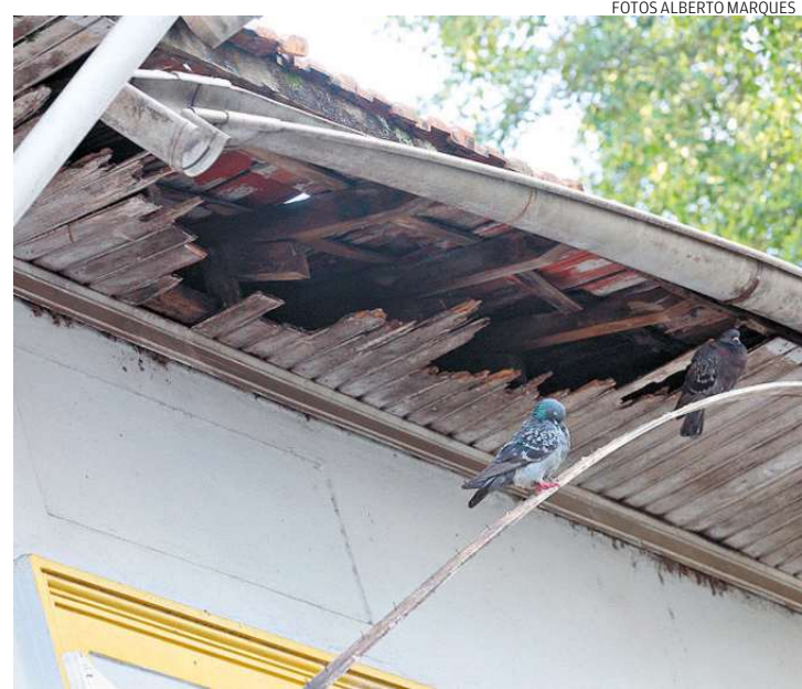
Parte do telhado e forro do prédio tem avarias e ameaça desabar
