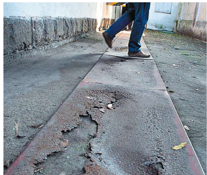
Placas de aço, instaladas para dar mais segurança, estão cedendo
