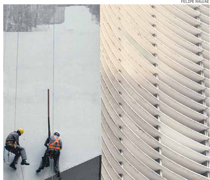
Emergência. Revestimento original está se descolando
