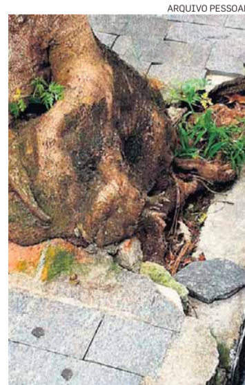
Calçada. Árvore causa dano
