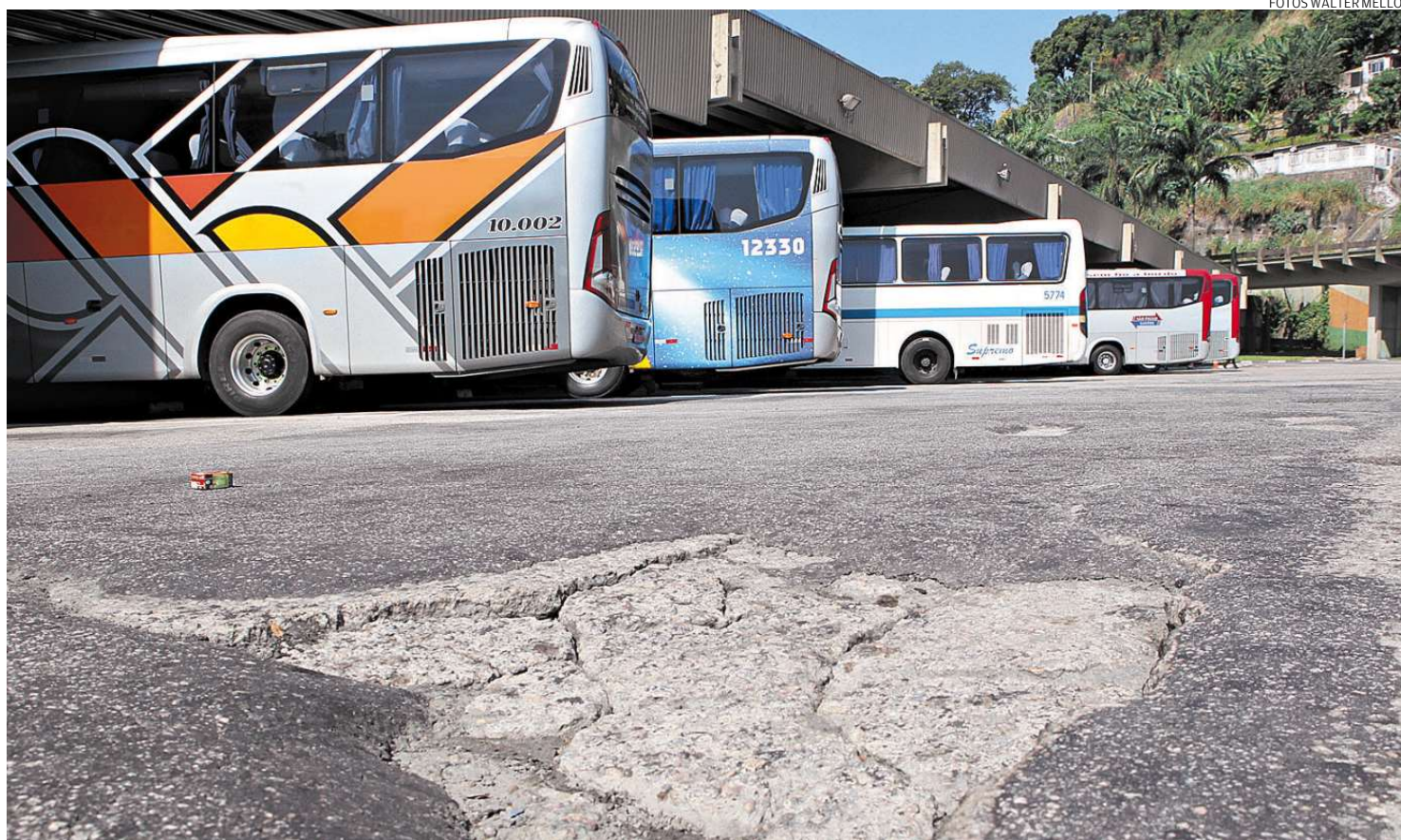
Alguns dos problemas são as rachaduras na área por onde os ônibus acessam as plataformas de embarque e desembarque e saem do local
