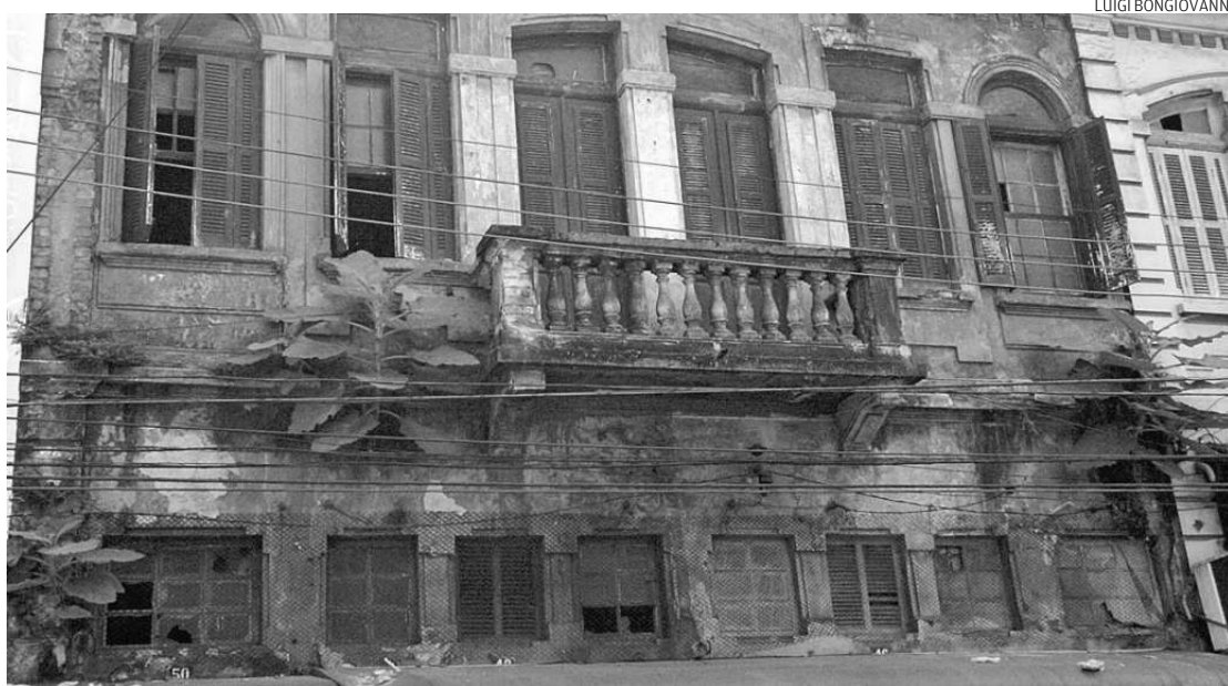
Deteriorado pela ação do tempo, o velho casarão na Avenida Senador Feijó oferece risco aos pedestres
