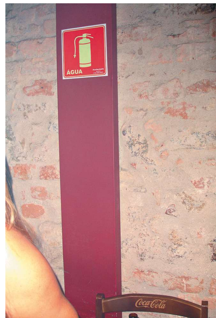
Já na casa noturna Antonina, o extintor de incêndio estava no chão
