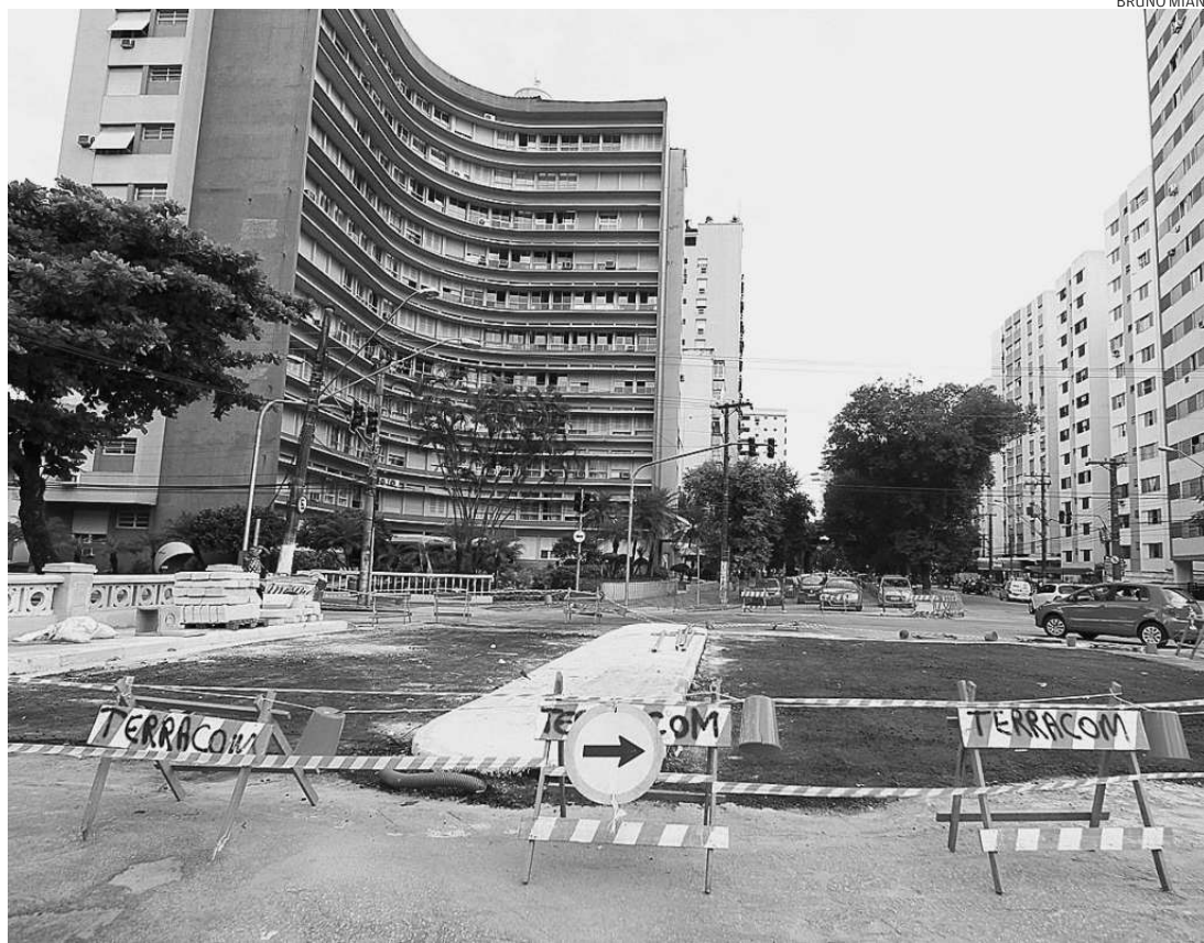
No Canal 6 com Avenida Epitácio Pessoa, a intervenção já passa dos quatro meses inicialmente previstos
