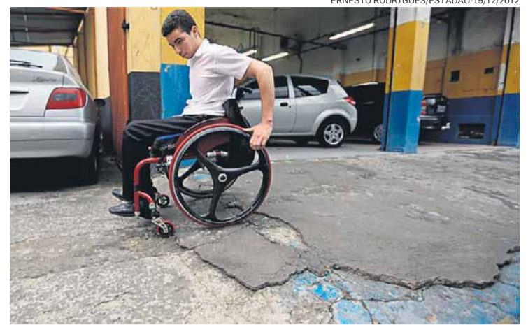
Dificuldade. Eduardo já caiu em passeio sem guia rebaixada
