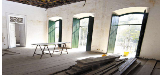
Vista do piso superior do prédio, em reformas: da janela central, o ator Nélio Mendes declamou Camões
