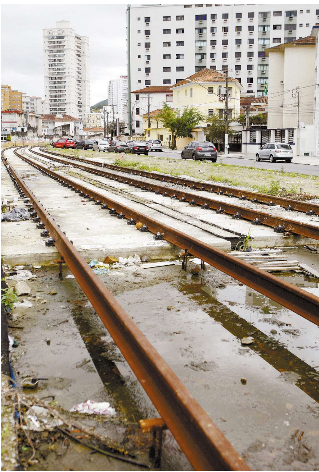
Após chuvas, a água se acumula nos pontos inacabados, por conta da paralisação determinada em março
