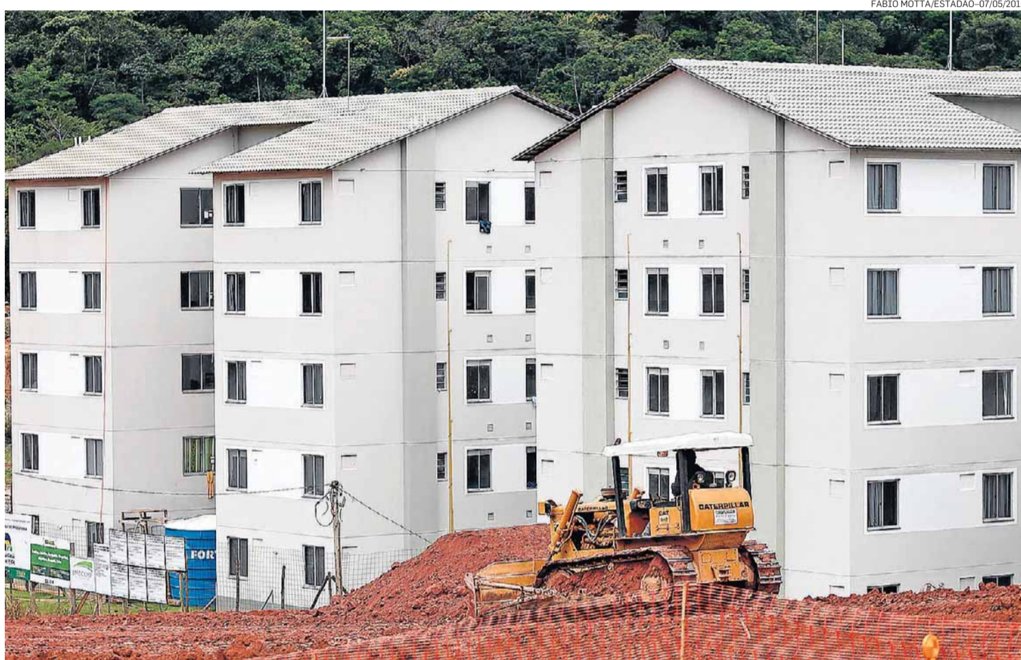
Readequação. Projetos do Minha Casa Minha Vida com menos de 10% das obras executadas podem ser paralisados
