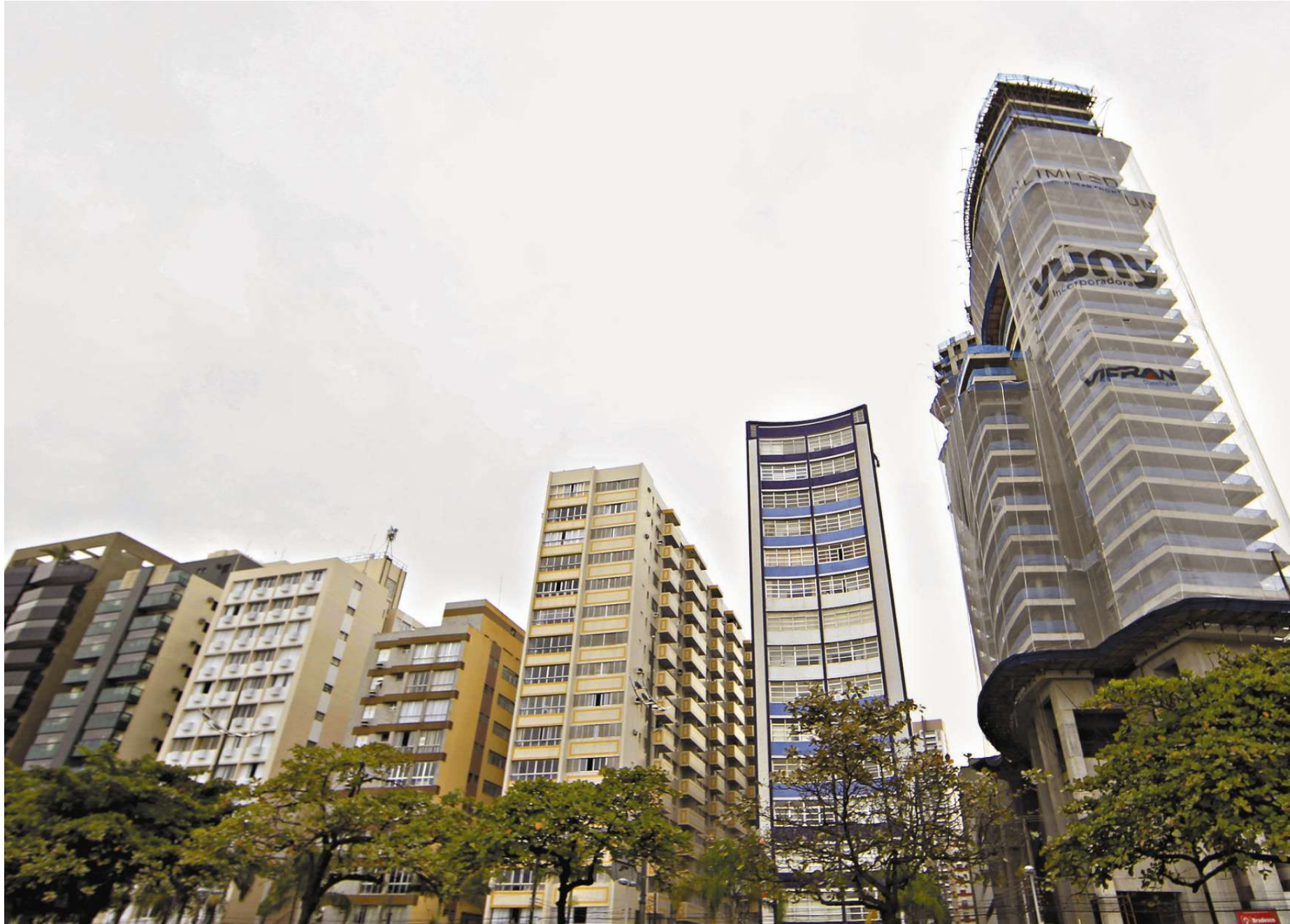
Torre de 40 andares em construção na Pompeia, em Santos: segmento residencial desacelerou, mas não parou, o que estimula grupos empresariais a apostarem na retomada
