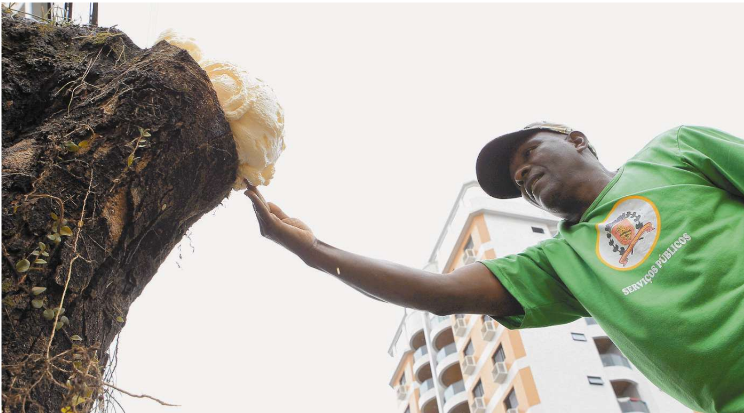
O ingazeiro de 75 anos já recebeu cupinicida (inseticida para cupim) e uma substância espumosa (foto) para evitar o processo de putrefação
