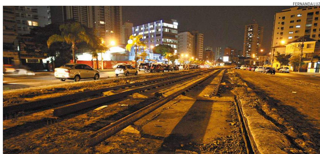
Obras estão paradas a partir do Canal 1; MP aponta mudança de traçado no primeiro trecho, negada pela EMTU
