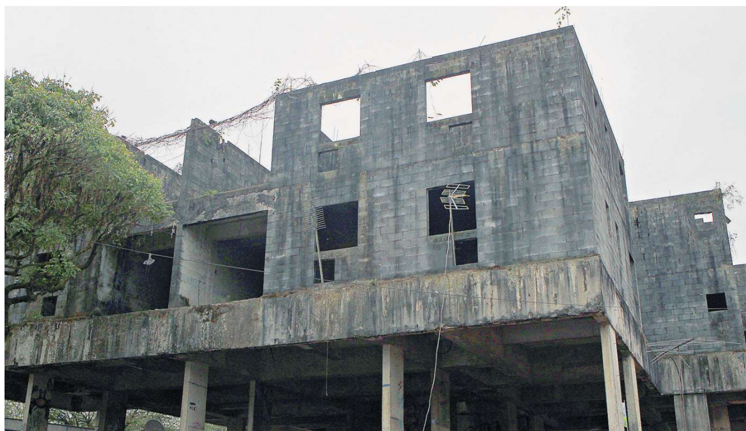
Esqueletos de edifícios abandonados permanecem pela Cidade, como esta edificação inacabada na Av. Siqueira Campos (Canal 4), no Embaré
