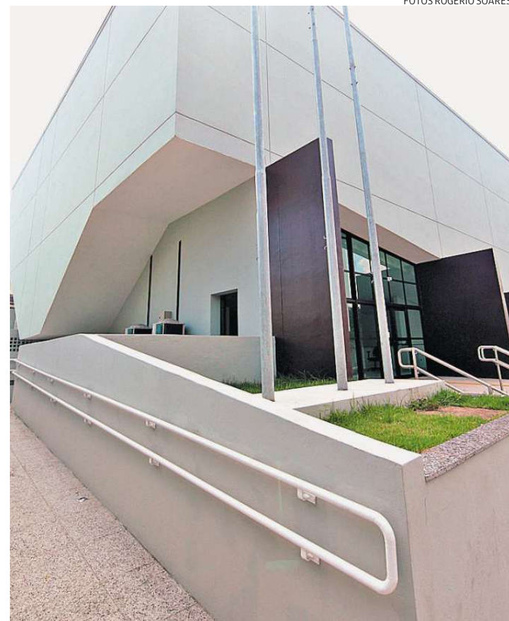
O auto de vistoria foi negado por causa da altura do corrimão
