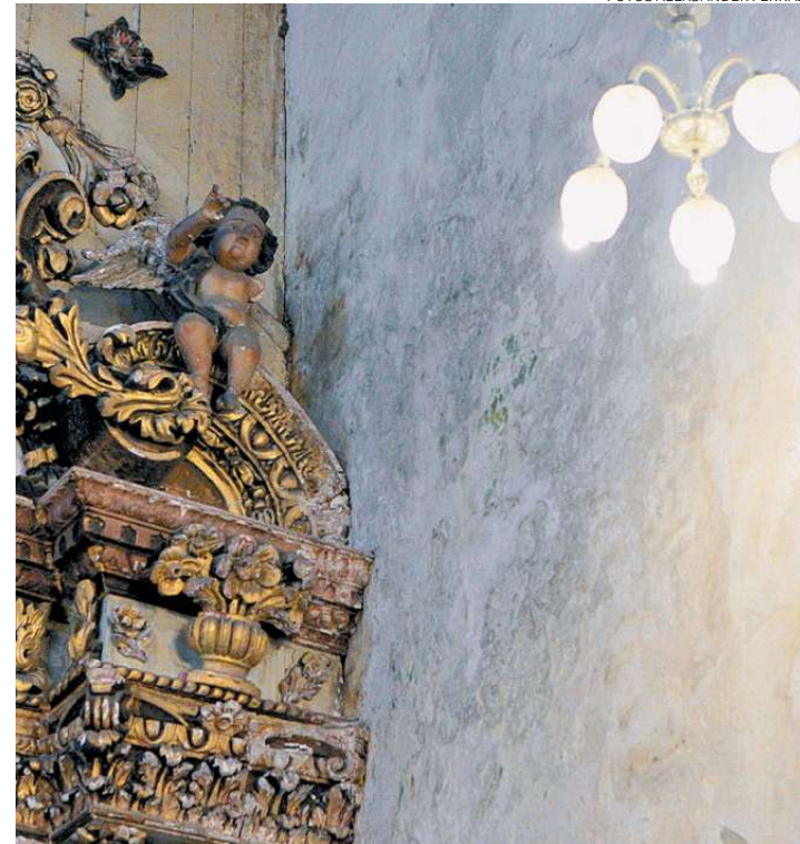
O detalhe dos sinais de infiltração nas paredes: renovação é vital
