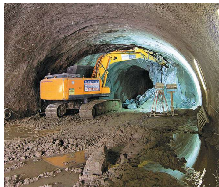
Santos tem ritmo lento de obras, mas túnel será entregue em janeiro
