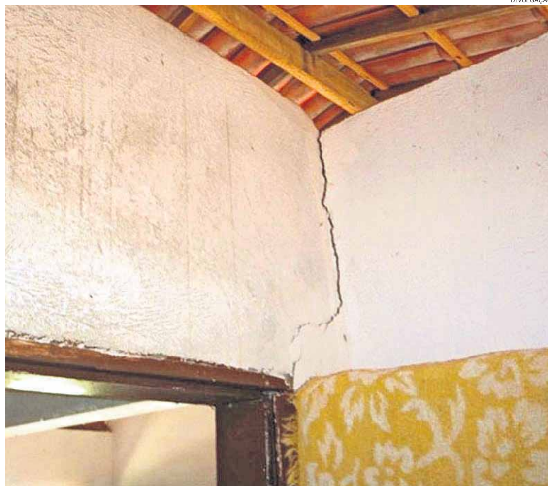
Risco. Rachadura em obra do programa Minha Casa Minha Vida em Areial, na Paraíba
