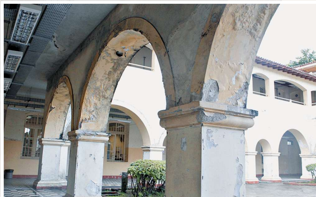
Nos imponentes arcos do pátio interno, revestimento está mofado e descascado. Há também infiltrações
