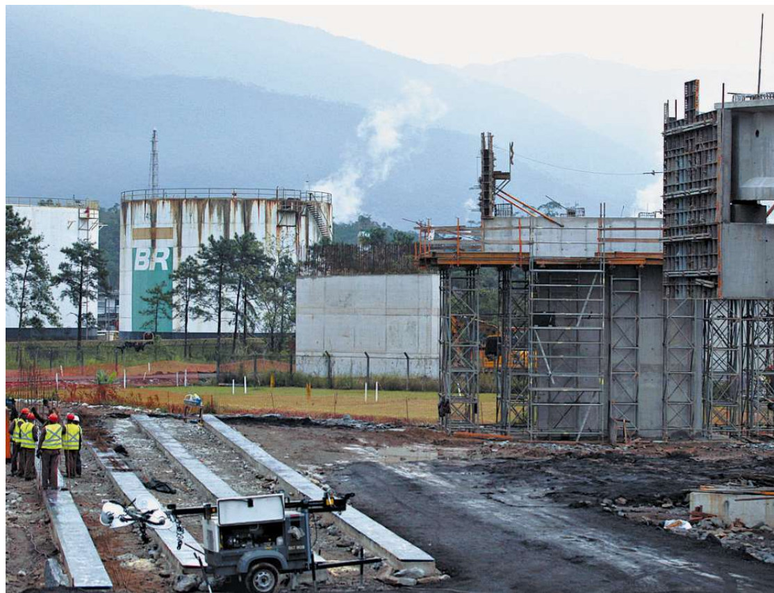
Obras do acesso viário ao lado da unidade da Petrobras: construção atende tanto ao polo como ao Porto
