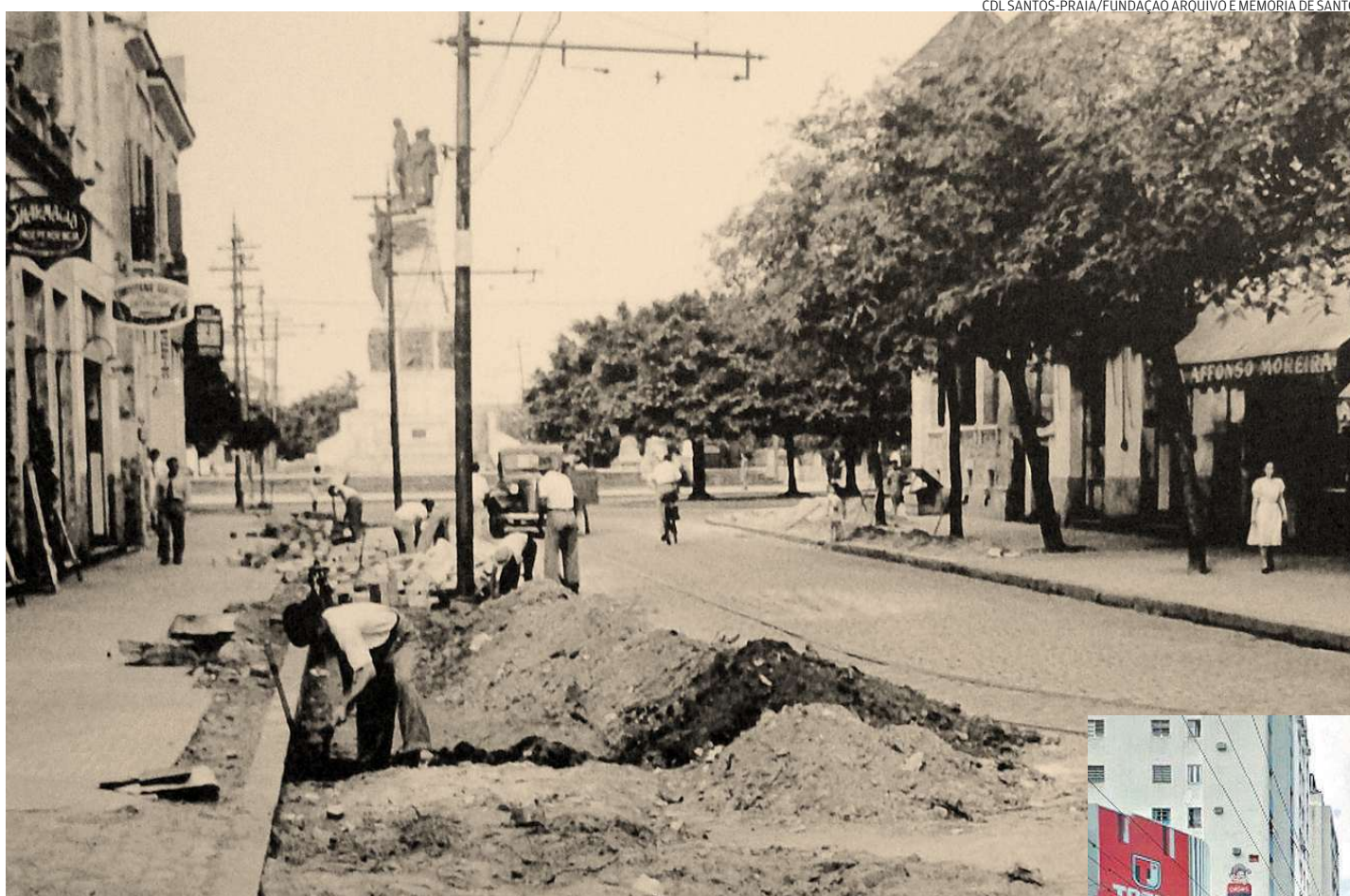
Em 1942, passando por uma das várias obras de modernização. Nota-se a predominância das casas
