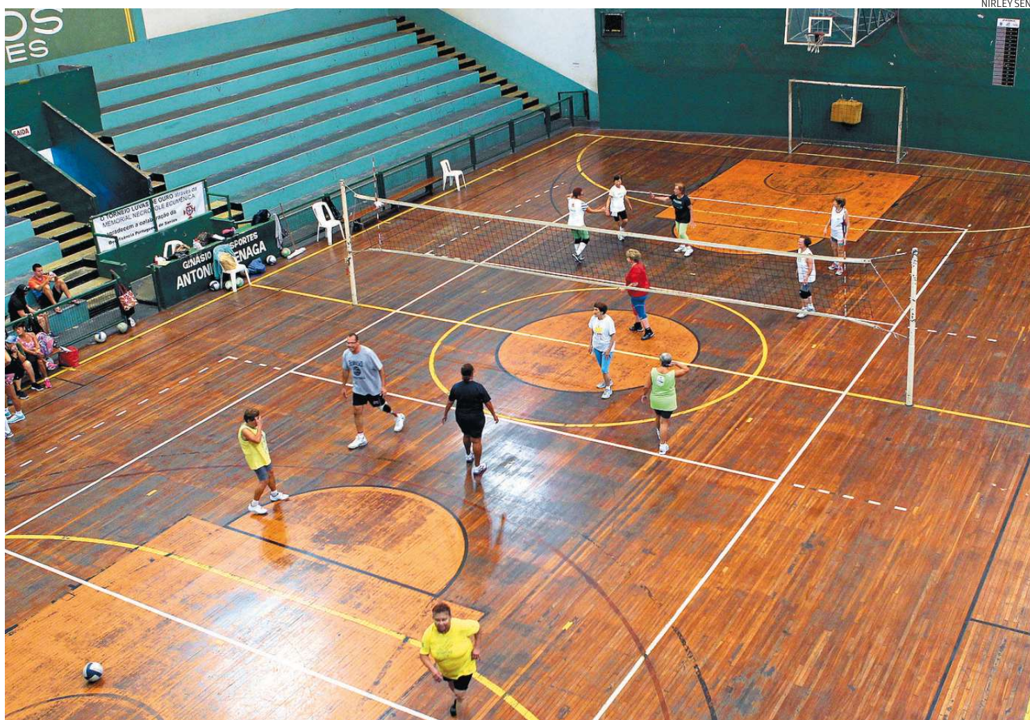
As arquibancadas são desconfortáveis e o piso das quadras está desgastado pela ação do tempo. Reparos estão previstos no plano de obras
