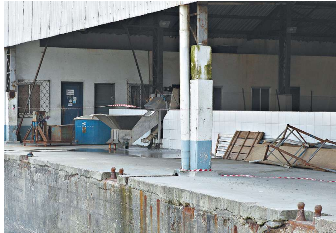
Terminal foi interditado por causa dos danos em seis colunas que ficam no salão de triagem do pescado
